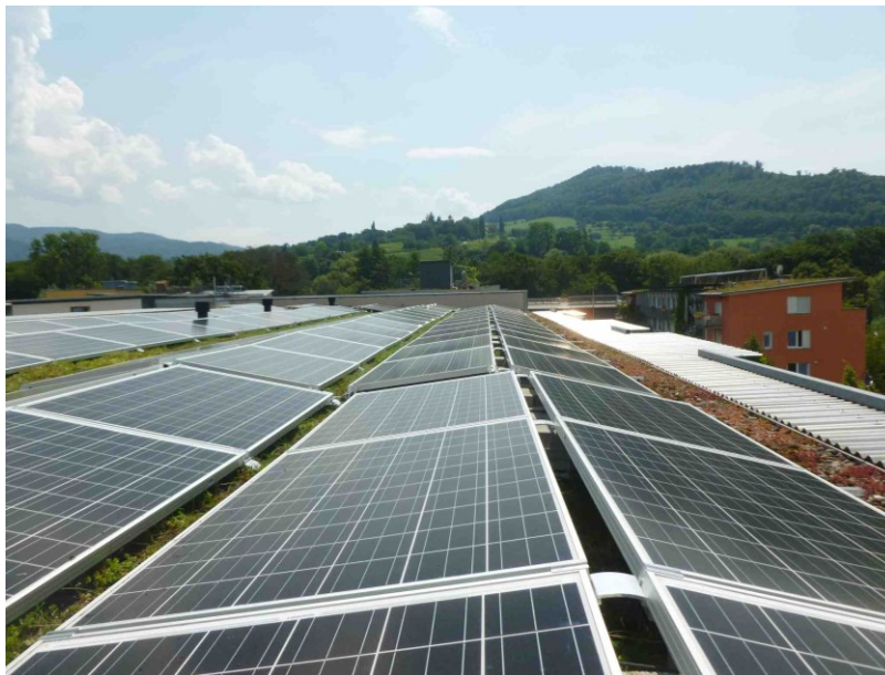
Beispiel für PV-Anlage mit Ost-West-Ausrichtung, Genova II, Inbetriebnahme Juli 2014
